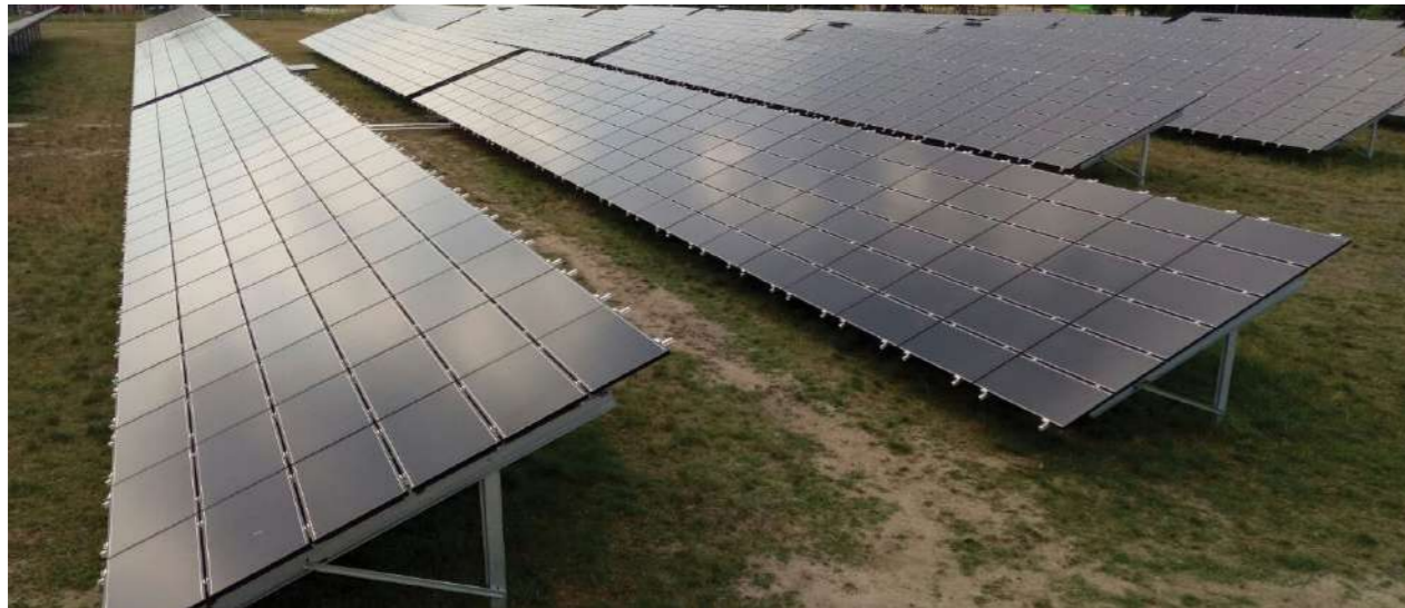
Egyházasharaszti (2x) - 560 kWp
